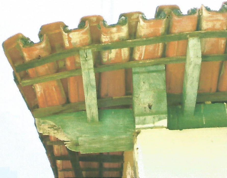
Foto 12 – beiral sobre cunhal (fachadas lateral direita e psoterior) com frechais e cachorros arrematados com perfilatura menos elaborada que os do corpo da nave. Péssimo estado de conservação.
