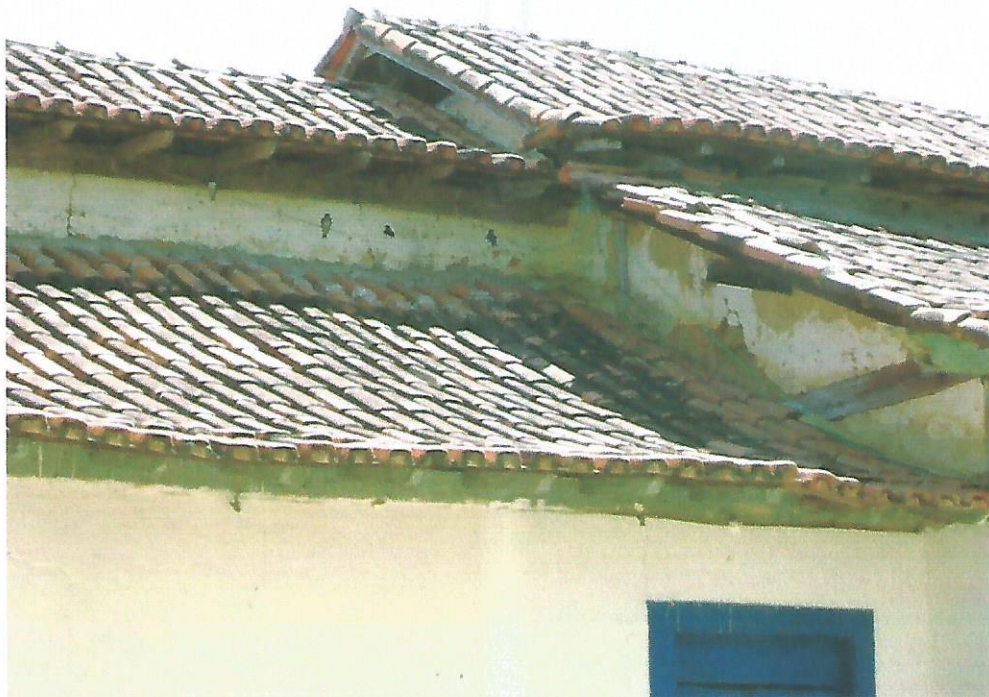
Foto 13- áreas de empenas, rufos e beirais em mau estado. Fachada posterior (corpo da nave e capela mor).
