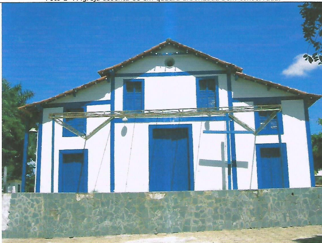
Foto 2- estrutura metálica para cobertura defronte ao bem cultural- elemento descaracterizante.
