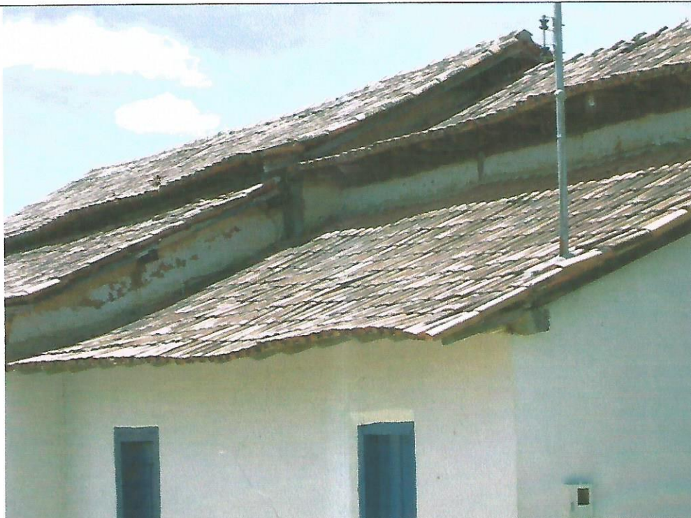
Foto 14- áreas de empenas, rufos e beirais em mau estado. Fachada lateral esquerda (corpo da nave e capela mor).
