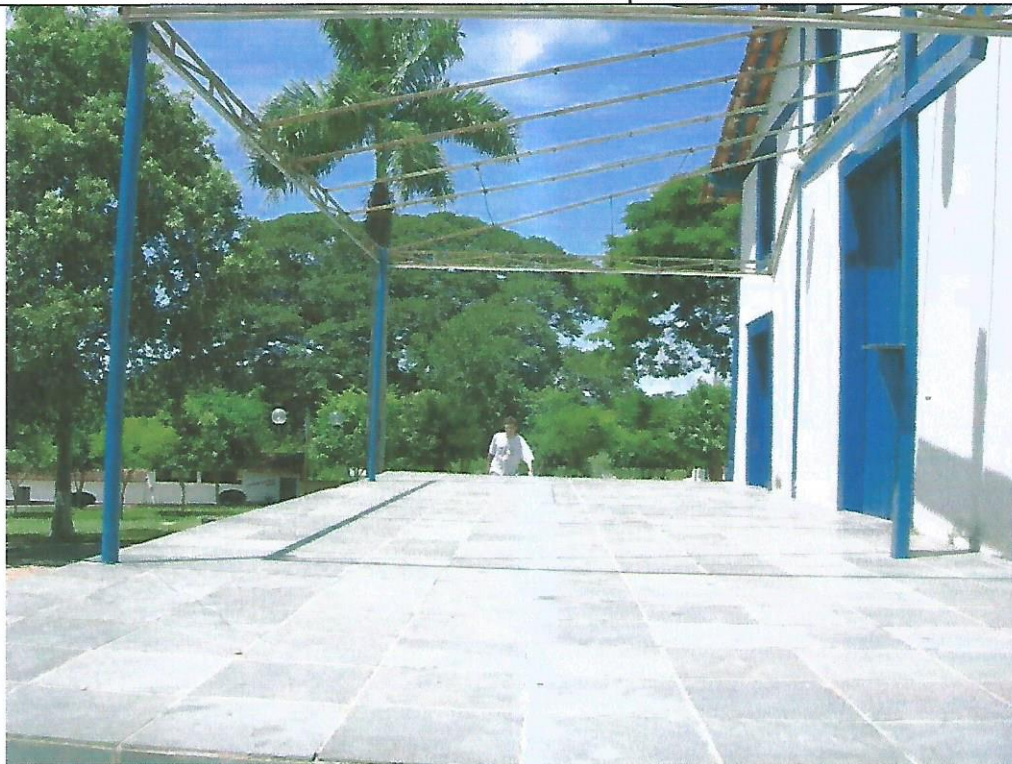
Foto 17- piso do adro em bom estado. Estrutura metálica totalmente descaracterizante.
