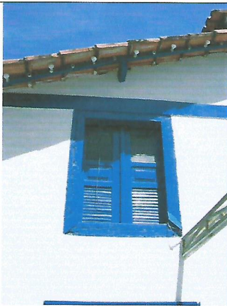
Foto 8 – Janela da fachada principal Aparentam ser intervenções às originais (sem referências)
