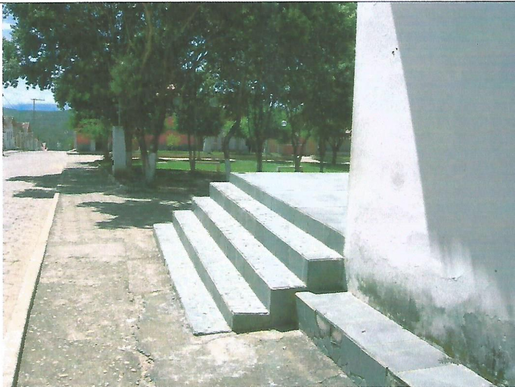
Foto 16- escada e baldrame com pedras soltas.
