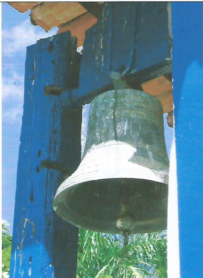
Foto 10- esteio da sineira com áreas atacadas pro térmitas e itnemperies.
